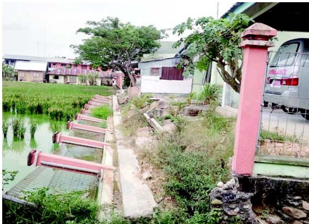
ROBOH: Bangunan pagar Puskesmas Kecamatan Langsa Timur yang roboh belum diperbaiki, Selasa (21/3).
